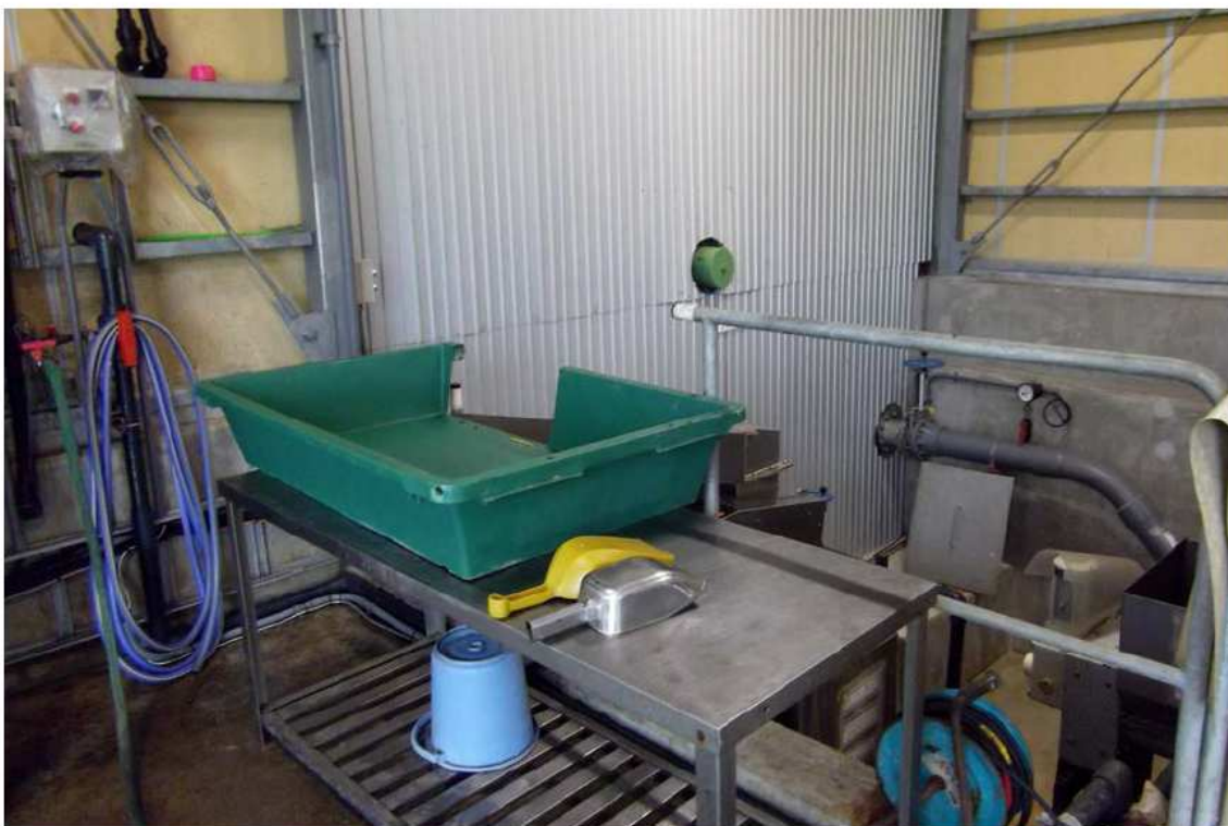
生ごみ受け入れ・粉碎設備
