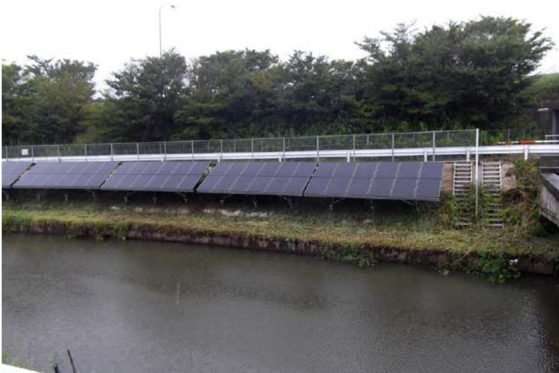
小松堀排水路法面に設置された太陽光発電設備
