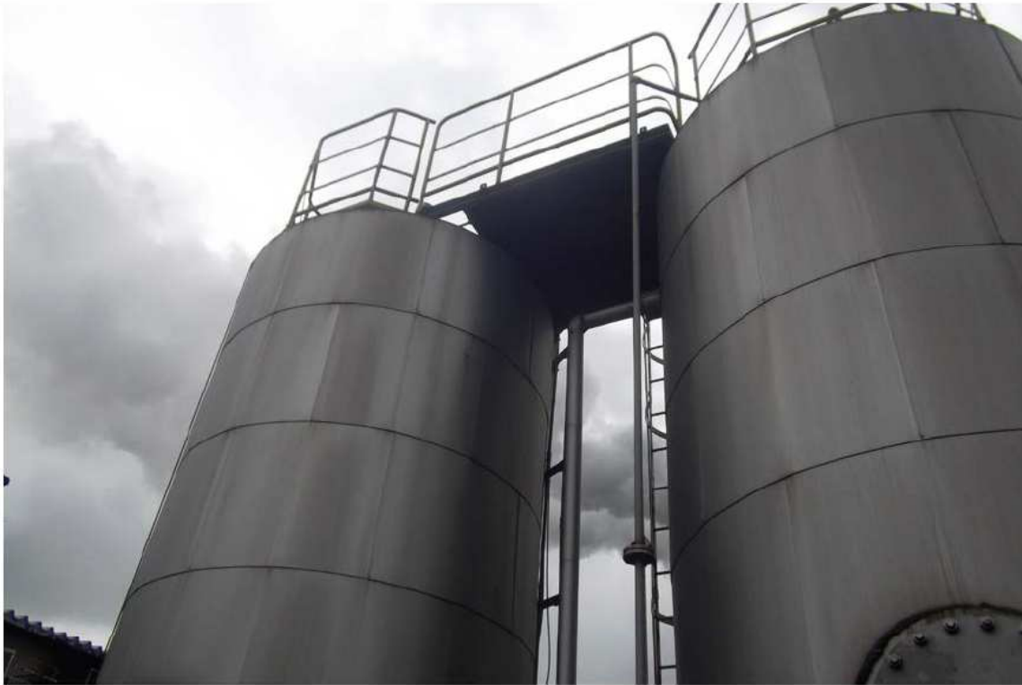
バイオエタノール製造設備糖化槽
