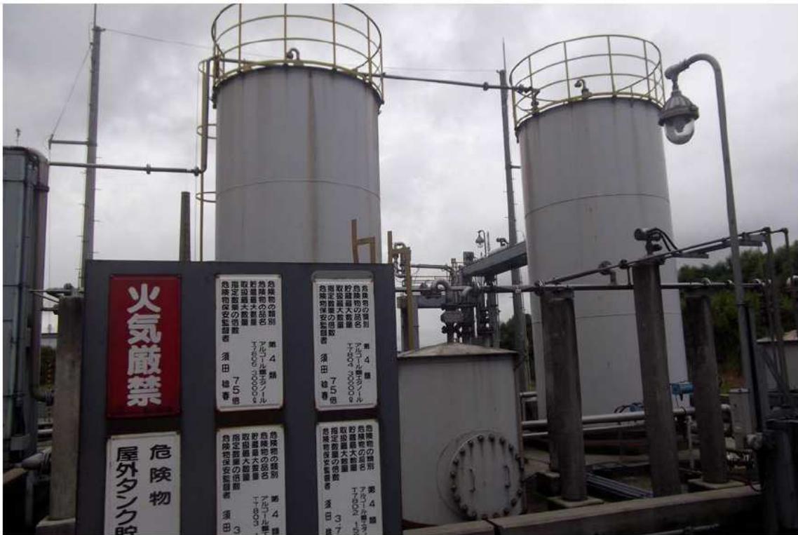
バイオエタノール製造設エタノール貯蔵タンク (組成を確認後、タンクに貯蔵、出荷時にも再度組成確認)
