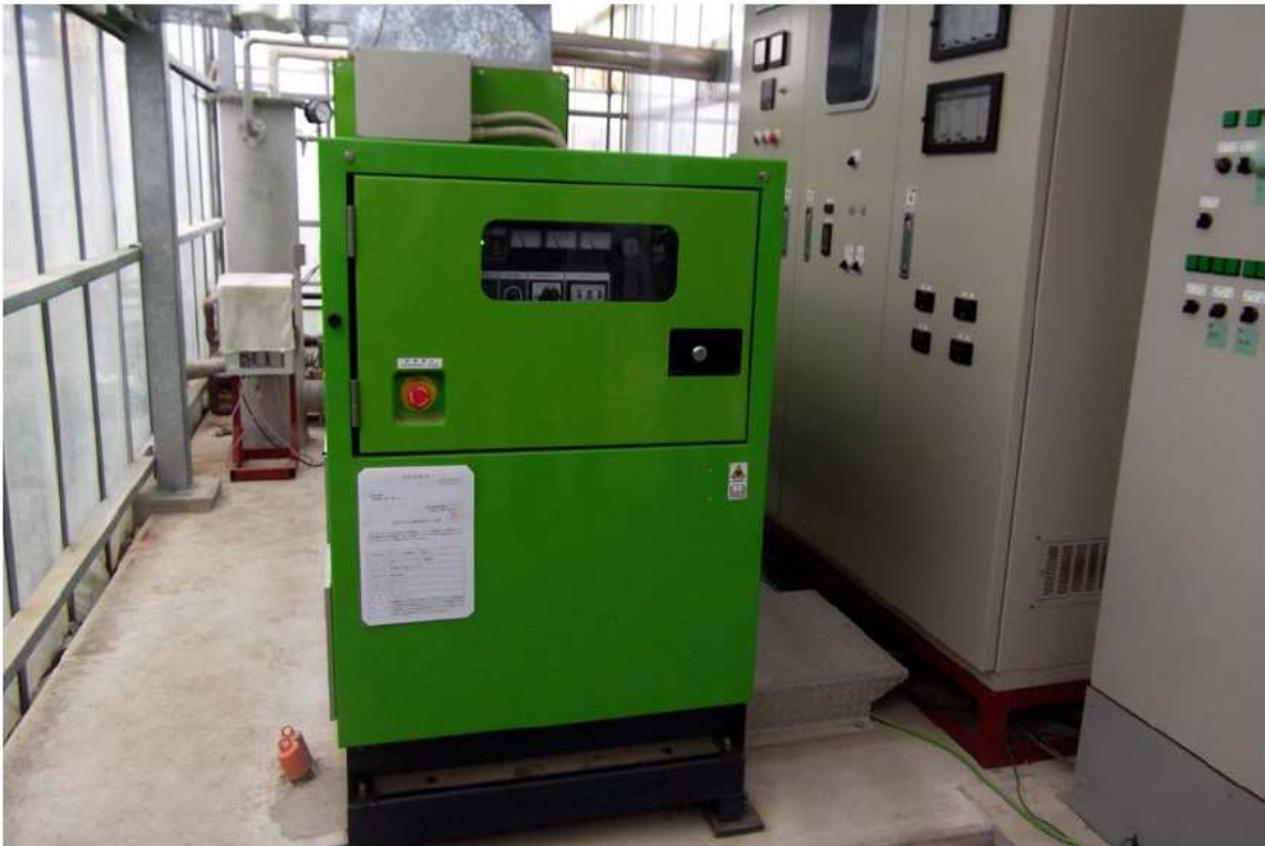
温室内に設置されたバイオガス発電機
