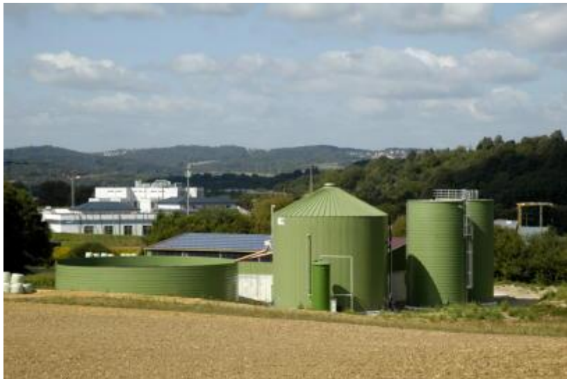
LIPP社バイオガス化プラントの一例
