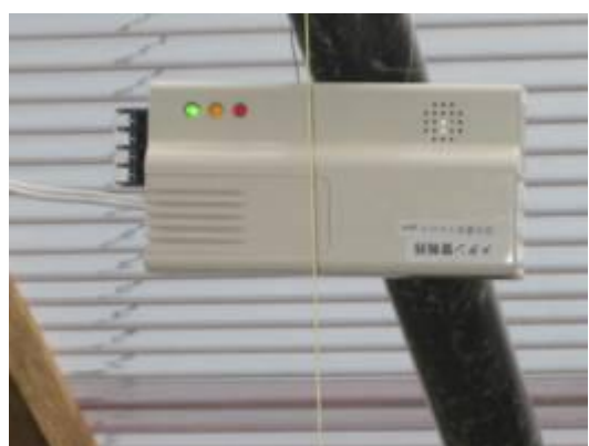
メタンガス検知器を取付けて安全にも配慮
