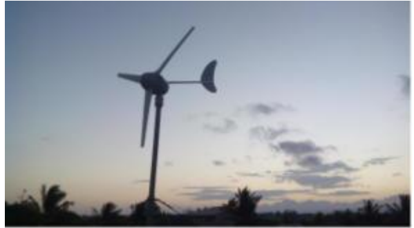
加工工場屋上に設置された風力発電機
