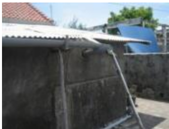
雨水の集水(雨樋より集水)
