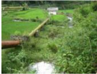
整備された小水力発電設備
