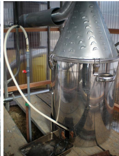
写真 3-5-6 手造りのガス燃焼装置（自費設置）
