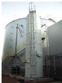
微生物脱硫装置
