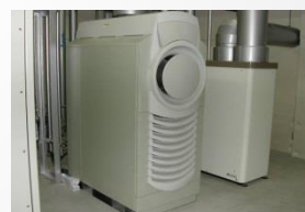
マイクロガスタービン 発電機 (メタン濃 度35%で使用)
