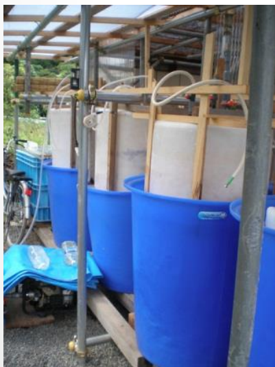
発電用ガス貯留槽（屋外）
