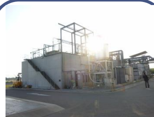
消化液処理設備
