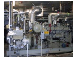
ガスエンジン発電機 (メタン濃度60～ 65%で使用)
