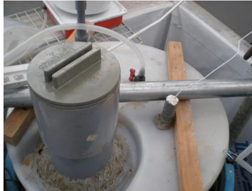
発酵槽投入口
