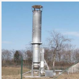
余剰ガス燃焼装置
