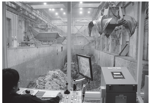
クレーン操作室・ごみピット
