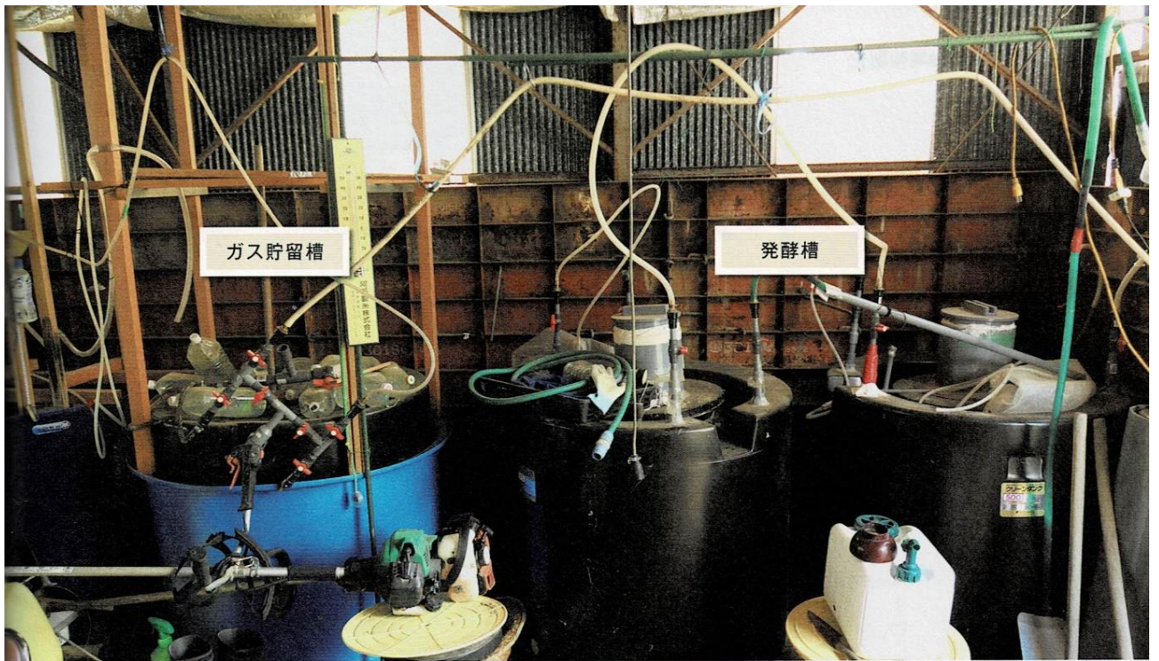
これは500ℓの発酵槽とガス貯留槽。冬は、タンク内に沈めたフレキシブルパイプに45℃のお湯を循環させて発酵を促進。発酵槽内を25～35℃に保つ
